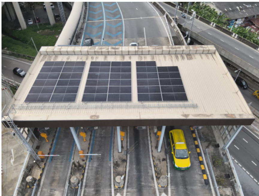
โครงการติดตั้งระบบผลิตพลังงานแสงอาทิตย์ บริเวณอาคารด่านเก็บค่าผ่านทางพิเศษศรีรัช
