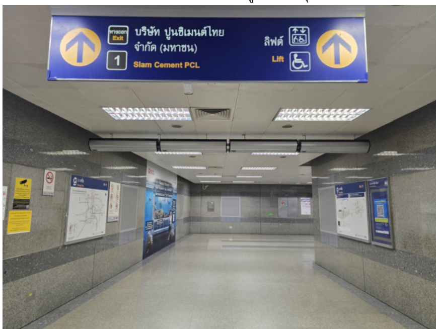
โครงการติดตั้งม่านอากาศบริเวณทางเข้า-ออก โครงการรถไฟฟ้าสายสีม่วง (ระยะที่ 2)
