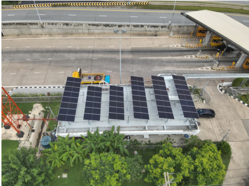
โครงการติดตั้งระบบผลิตพลังงานแสงอาทิตย์ บริเวณอาคารด่านเก็บค่าผ่านทางพิเศษอุดรรัถยา
