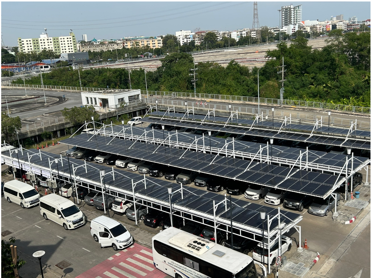
โครงการติดตั้งระบบผลิตพลังงานแสงอาทิตย์บนหลังคาลานจอดรถ
