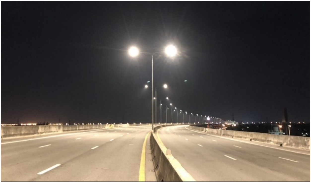
โครงการเปลี่ยนโคมไฟถนนบริเวณ Mainline ทางพิเศษประจิมรัถยา (SOE)
